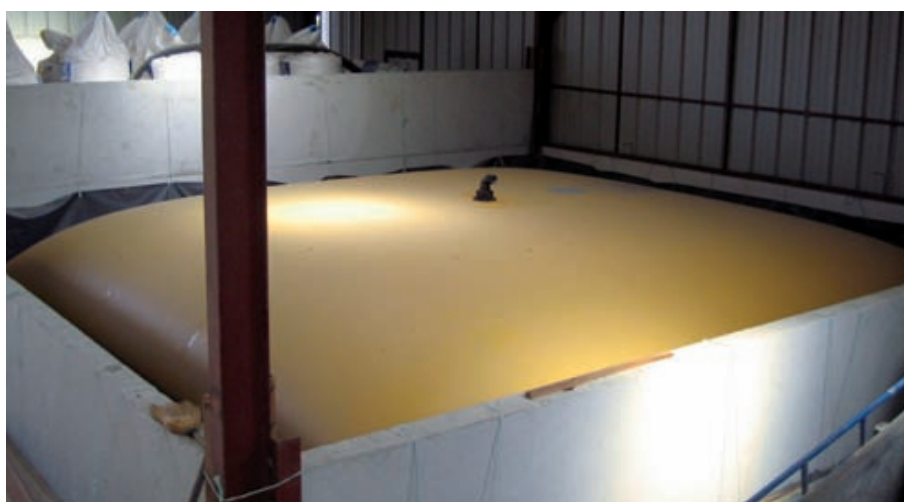
50m 3 solution azotée avec rétention par bassin et fosse
