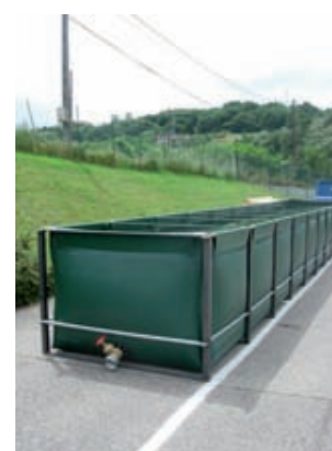
Bac de rétention
